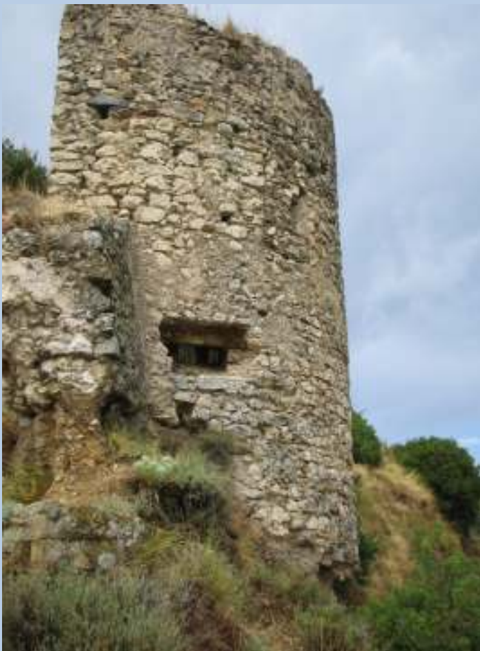
Torre Est scalzamento al piede ad opera dell'erosione e del dilavamento.
